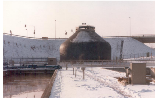
Faulbehälter (Biogas-Fermenter) im Klärwerk Haltern, innen mit Plastadur-P geschützt und abgedichtet.
